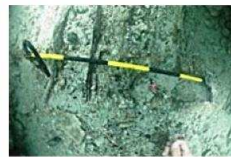
39-IMG_209-N of C7 Eroded frame im
